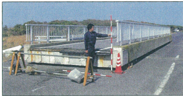
写真-1 流失した桁
