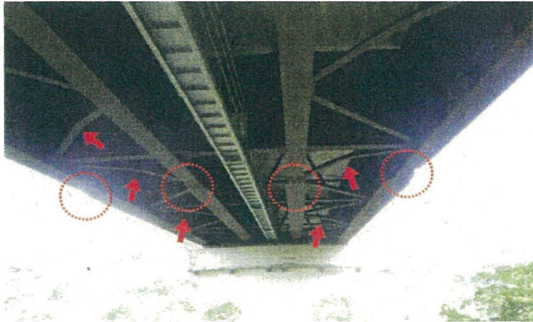
写真-1 主桁下フランジおよび下横構の座屈
