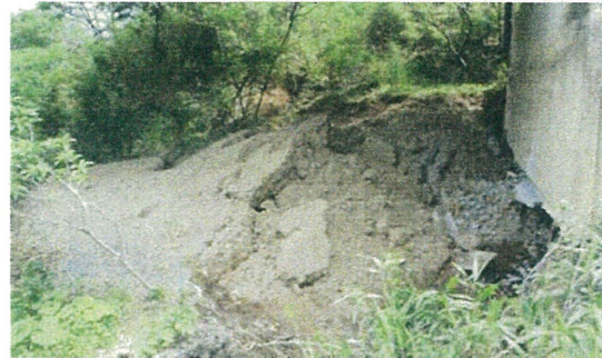
写真-3 A1橋台前面の表層斜面くずれ
