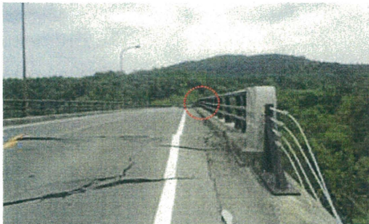
写真-2 主桁下フランジ座屈位置での床版の変形
