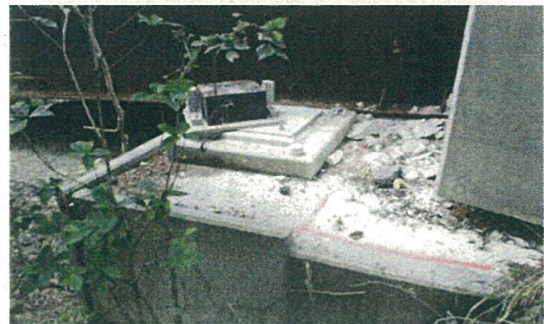
写真-5 A2橋台のパラペット下端破断と移動
