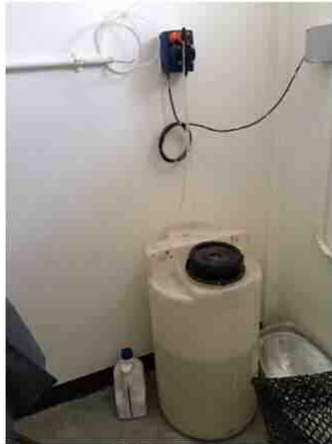
写真 4.3.8 消毒器設置状況
