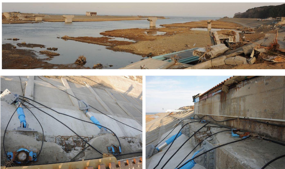
図 1.1.1 小泉大橋：橋脚の流出と橋台部の破壊状況
