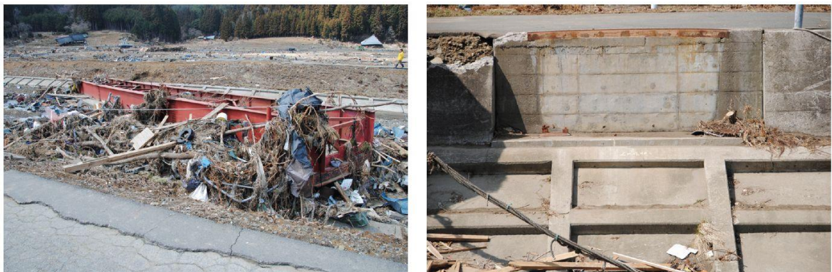
図 1.1.3 橋梁名不明：横転した桁と支承が破断した左岸側橋台
