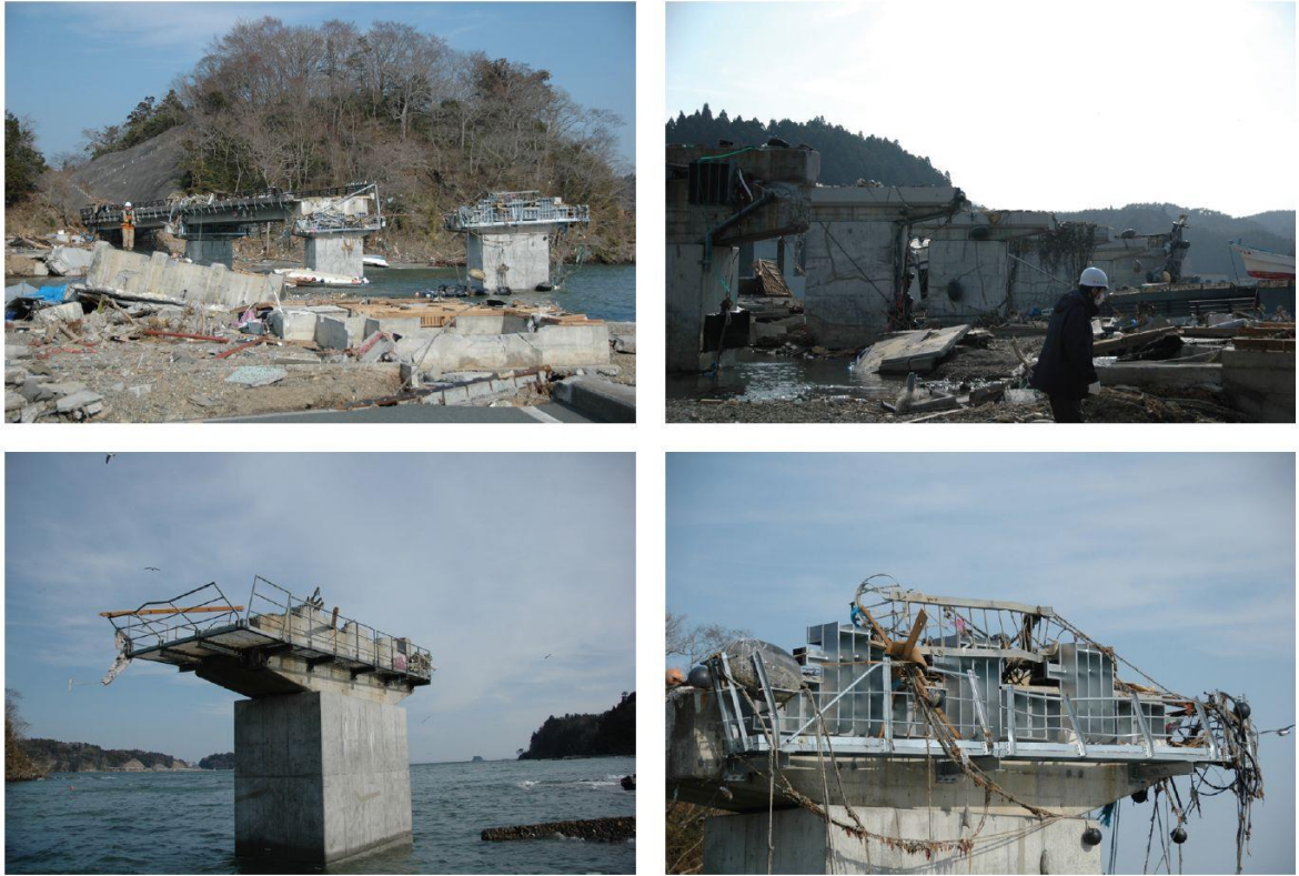
図 1.1.2 歌津大橋：橋脚と落下した桁
