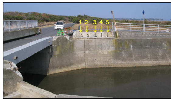
図3.2.3 桁流出後のアンカーバー
