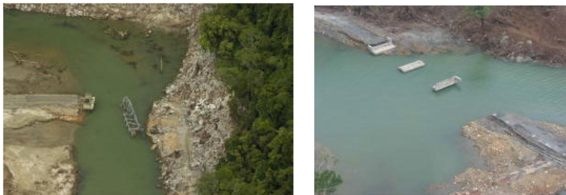
図 1.1.4 流出したトラス橋（左），橋梁の流出と洗掘された土壌（右）
