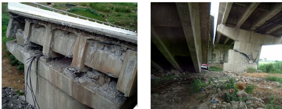
図 1.1.2 烏溪橋の被害状況
