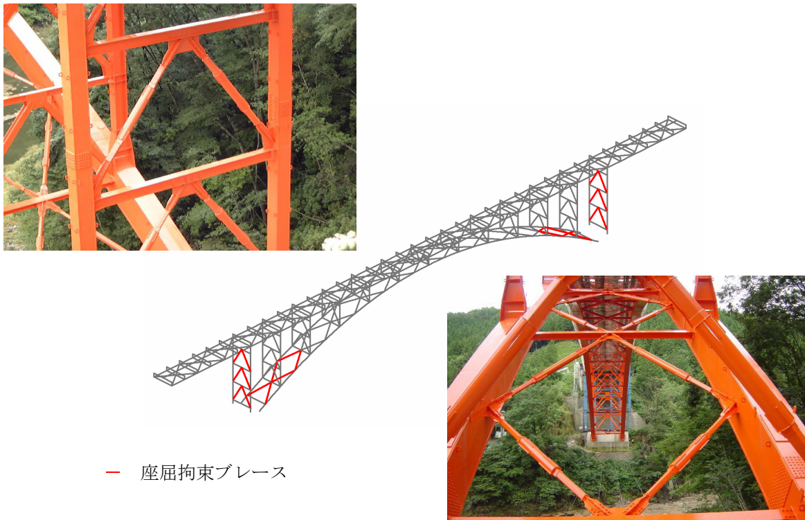
図 7.2.2 座屈拘束ブレース設置例
