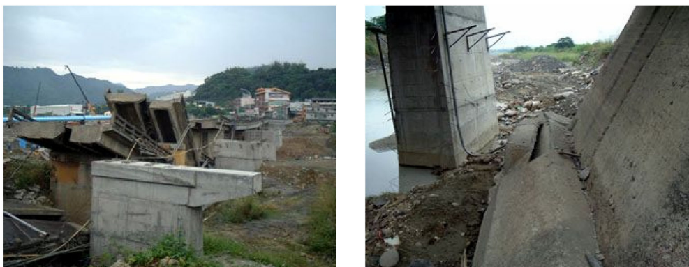
図 1.1.1 一江橋の被害状況
