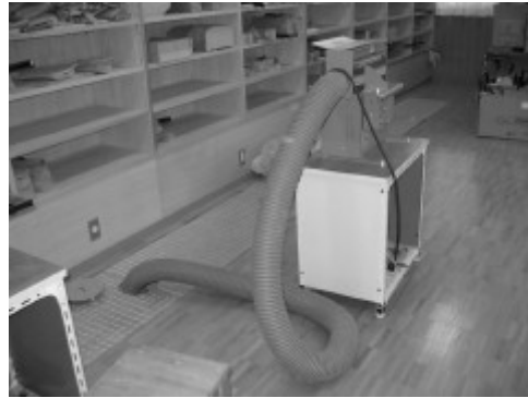
写真 13 集塵設備と機械を接続するホース
