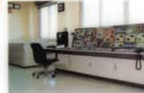
操作室(制御装置)
