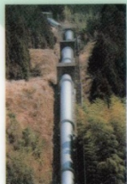
送水管(鋼管φ1,800)
