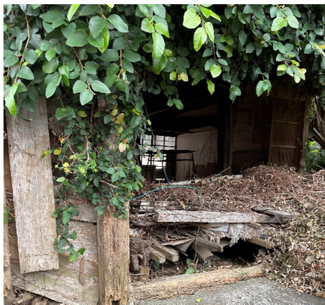
写真 1-3 下浜地区にて確認した倒壊寸前の空き家
