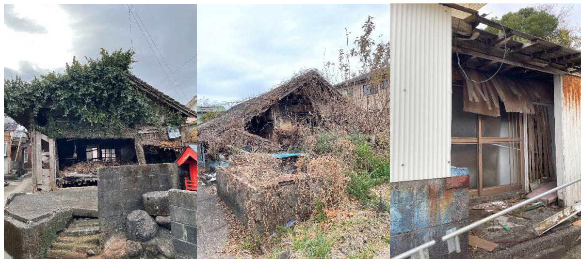
写真 6-5 下浜地区現地調査にて確認した路地を通った先の特に損壊の激しい空き家 撮影：甲斐（2023年1月13日）
