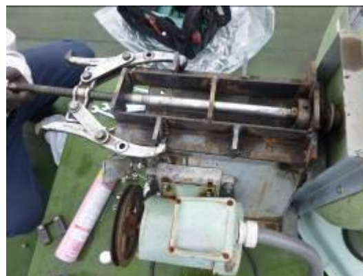
図 12 局所排気装置のベアリングユニットの交換作業（平成 26 年度）
